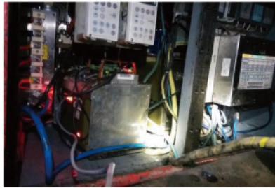
(b) 采煤机定位定姿装置在采煤机的安装
